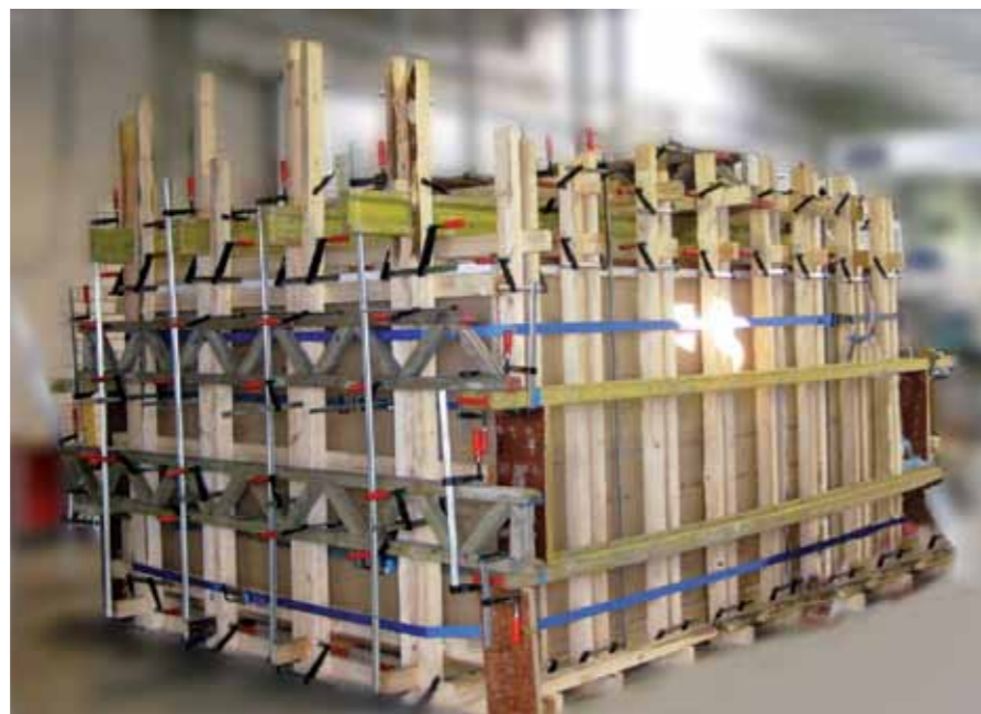
Stark gesichert: Eine ausgefeilte Konstruktion hält den auftretenden Gießdruck- und Auftriebskräften mühelos stand.
