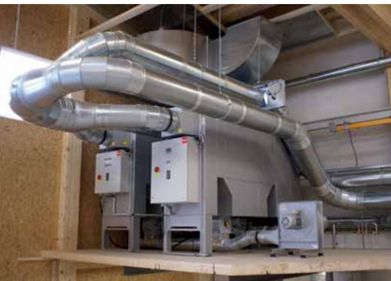
Absaugzentrale für einen maximalen Volumenstrom von 20.000 m³/h
