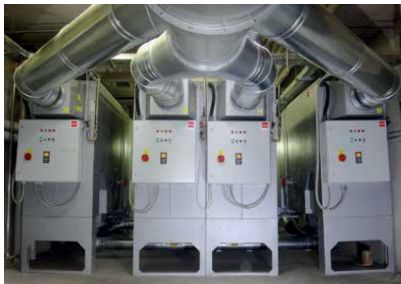
Absaugzentrale für einen maximalen Volumenstrom von 40.000 m³/h Bilder: Spänex
